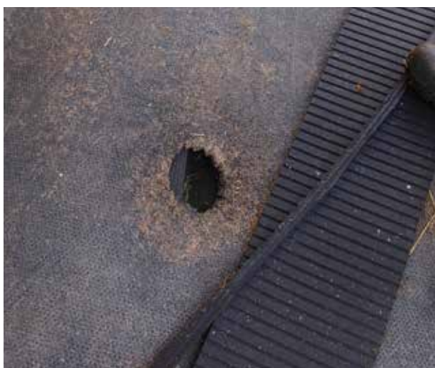
Figur 16. Svagt punkt i gummigulvet. Måtten blev udskiftet straks pga. fabriktionsfejl
