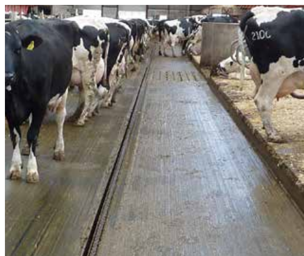
Figur 18. Gulvet er eftermonteret med flere skrue ved foderbordet så det ikke skubbes ud over rillen til skraberwiren/-kæden
