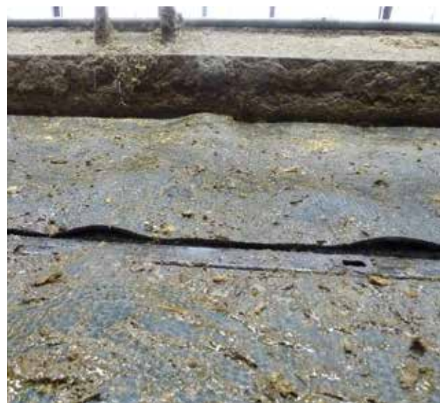
Figur 19. Ujævne gulve og tunge skraber er en dårlig kombination
